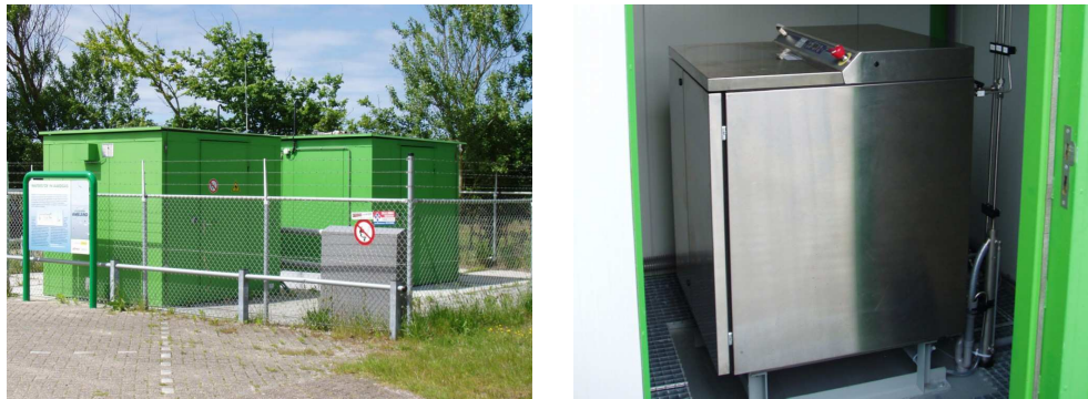
Figuur 3: Menginstallatie gevoed met waterstof uit de elektrolyser
